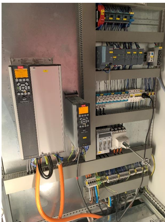
Bild 1: Steuerschrank (ggf. Bild der neuen Steuerung)
