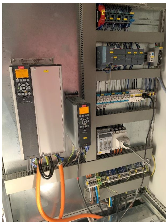
Figure 1 : Armoire de commande (le cas échéant, image de la nouvelle commande)
